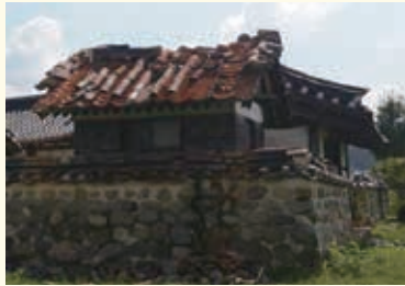
• 사마소 지붕 기와 파손
