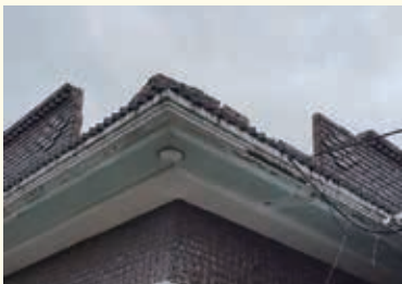
• 주택 지붕 난간 파손
