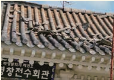
• 무형문화재 전수관 지붕 기와 파손
