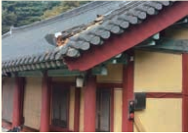
• 불국사 지붕 기와 파손
