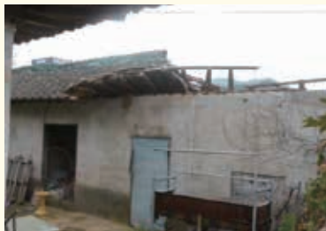
• 창고 지붕 파손
