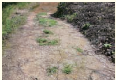
• 사곡지 저수지 둑 균열
