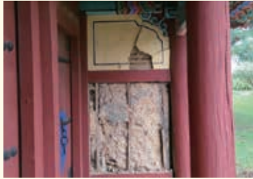
• 신문왕릉 벽체 파손
