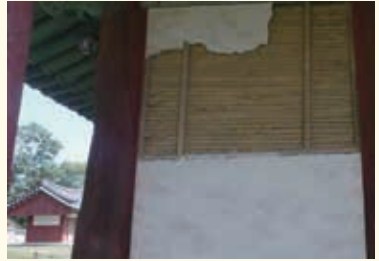
• 경주 향교 벽체 파손
