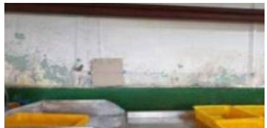
▲ 작업장 내 페인트 탈락
