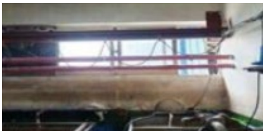
▲ 작업장 내 페인트 탈락 및 곰팡이 발생
