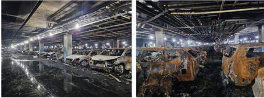
〈그림 5〉 인천 청라동 아파트 전기차 화재 사례(차량 피해 사례 및 천장 배관 보온재에 의한 화재 확대) (출처 : 세이프투데이, 소방방재신문)
