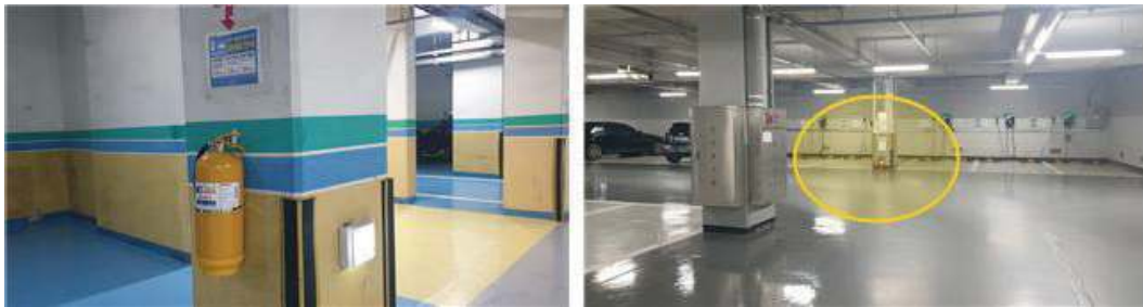
〈그림 37〉 전기차 충전구역에 D급 소화기 배치(좌), 전기차 충전구역에 근접 배치된 소화기(우)
