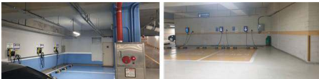
〈그림 39〉 화재감지기가 설치되지 않은 전기차 충전구역
