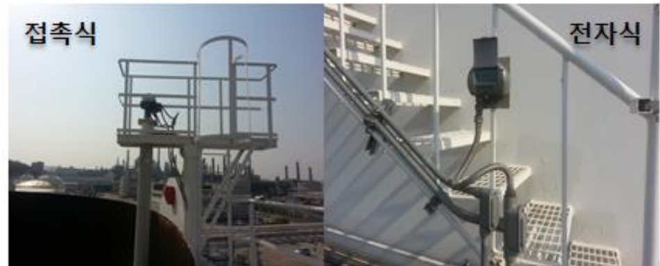
방유제에 설치된 접촉식 및 전자식 알람
